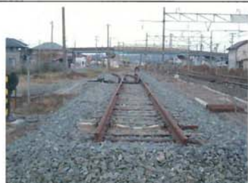
軌道設備全体
