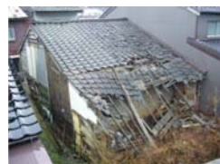
放置されたままの老朽住宅
