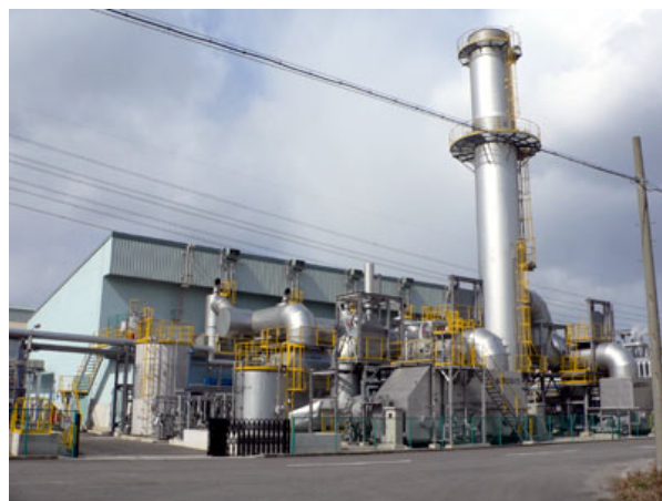
東田天然ガスコジェネ発電所 外観写真
