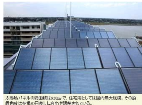
越谷レイクタウン（埼玉県越谷市） 太陽熱パネルの面的導入
