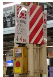
図3:非常停止押しボタン
