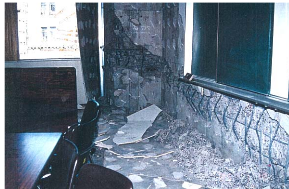
内部の被災状況
