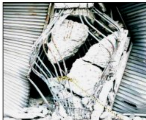
店舗1階柱の圧壊
