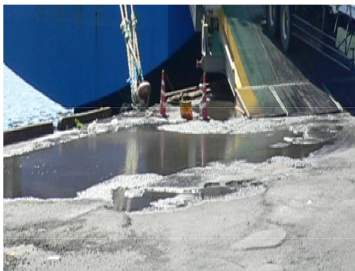
エプロン舗装の劣化状況
