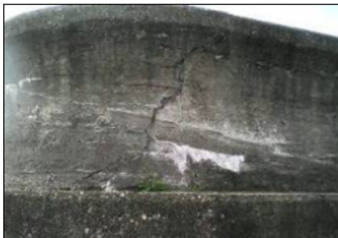
堤体のひび割れ
