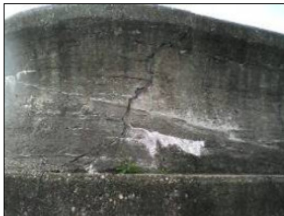
堤体のひび割れ
