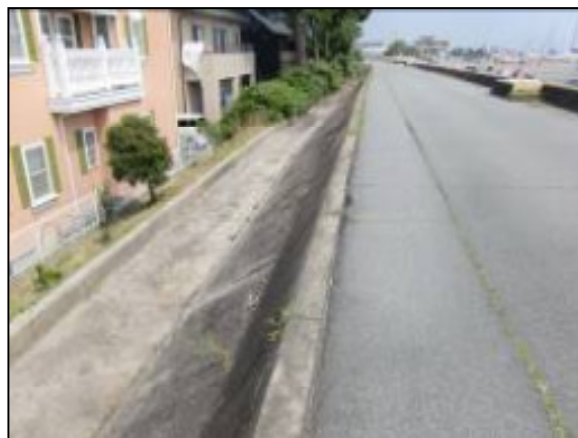
住居等に近接する老朽化した堤防
