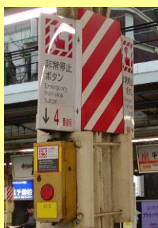
非常停止押しボタン
