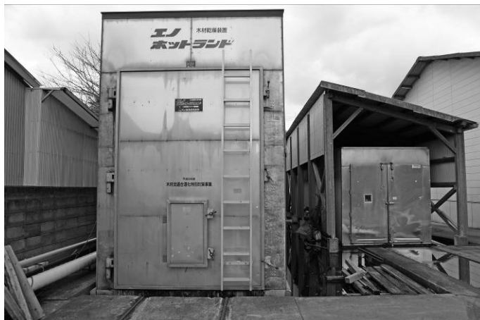
写真 木材乾燥装置（日田木材協同組合敷地内）
