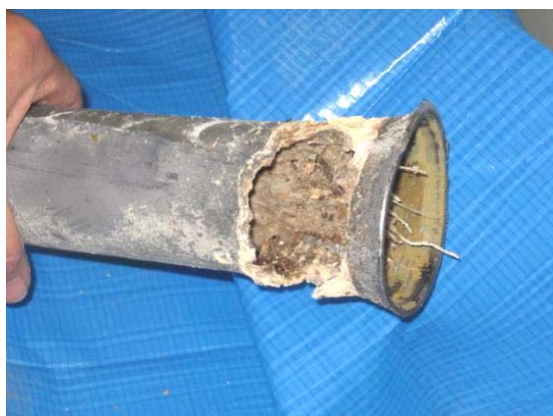
腐食した排水管
