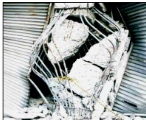
店舗1階柱の圧壊
