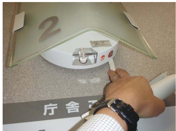
〈非常用照明の点灯不良〉
