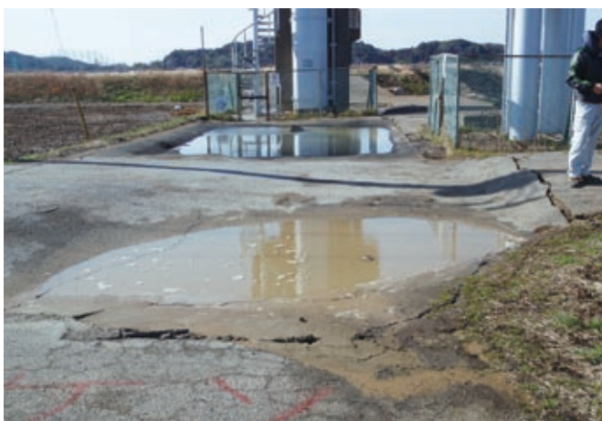
水管橋周辺の沈下
