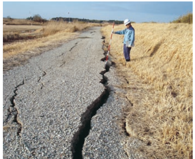
調整池管理用道路に入った亀裂
