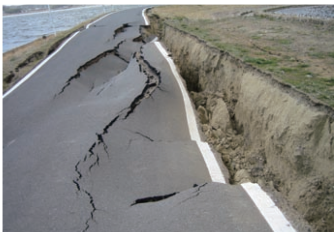
沈下・亀裂が生じた霞ヶ浦の堤防
