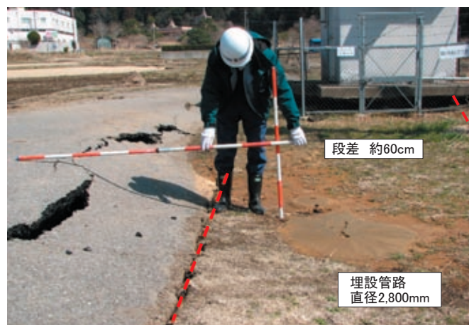
管路上部の沈下
