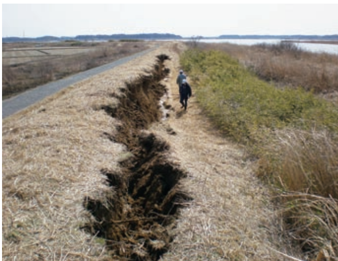
亀裂が生じた調整池堤防
