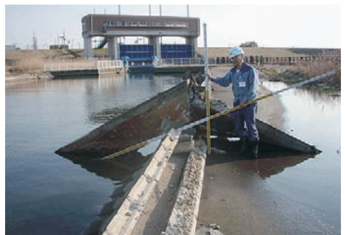
取水口の護岸ブロックの損傷
