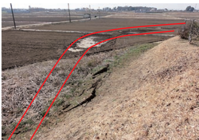
埋設管路上の地表面の沈下・亀裂
