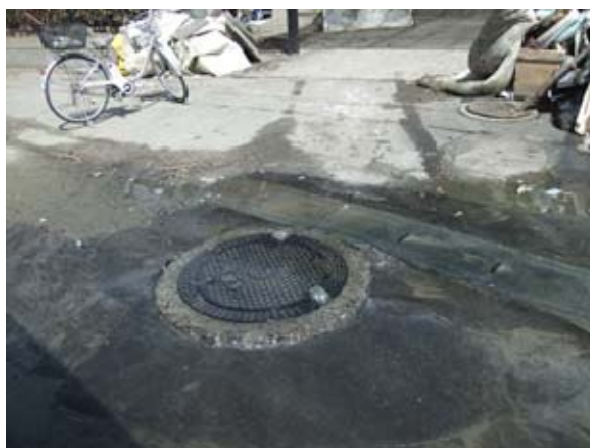
マンホールからの溢水の状況（宮城県七ヶ浜町内） ※その後の対策により現在は解消（資料:国土交通省）
