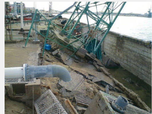
材料搬入の港湾施設の被害(別の港湾施設に代替)
