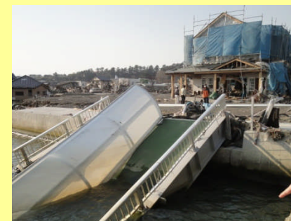
被災した事務所兼待合所
