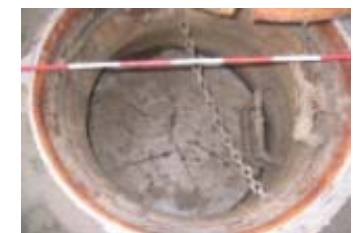
マンホールの閉塞
