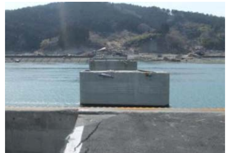
全スパン流失 (国道45号線 陸前高田市 3/29)
