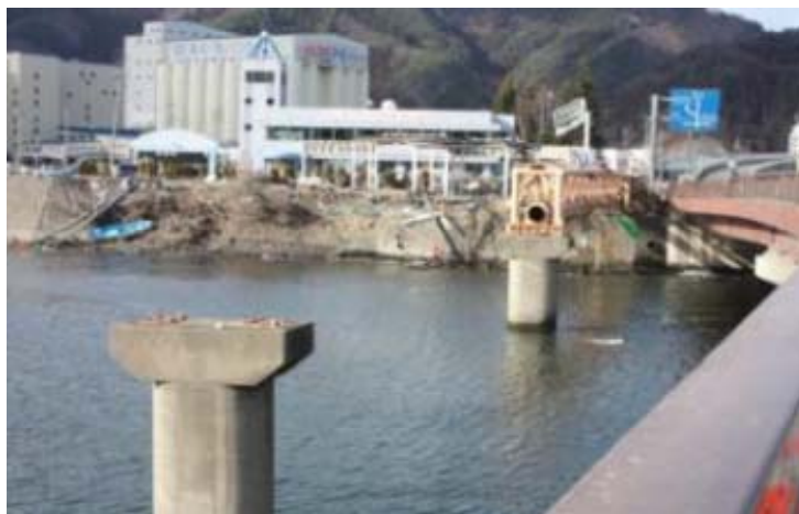
落下した水管橋 平成23年3月28日
