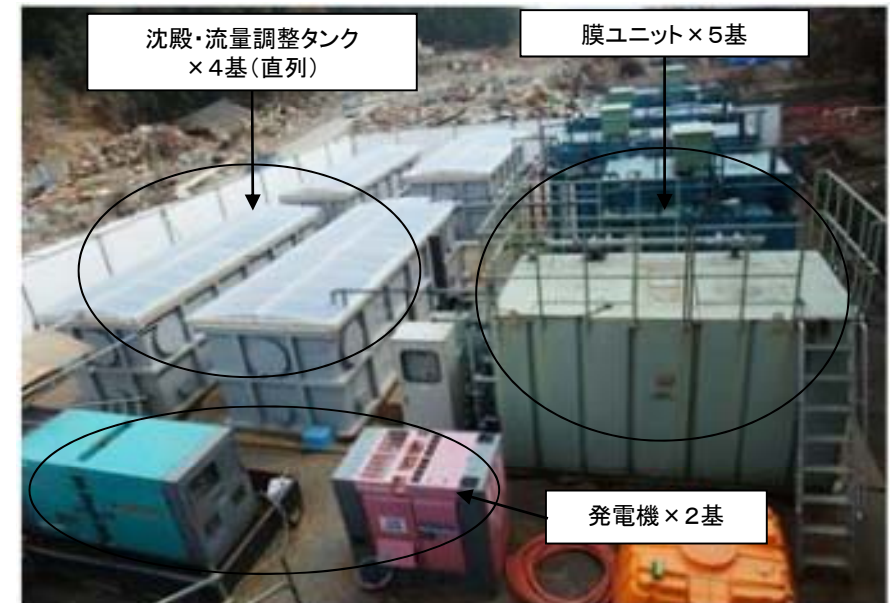
現地設置状況
