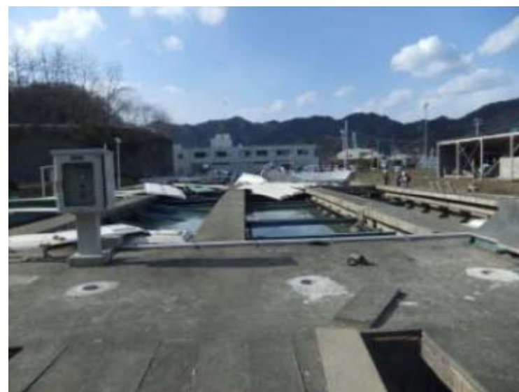
水処理上部 蓋等が流失
