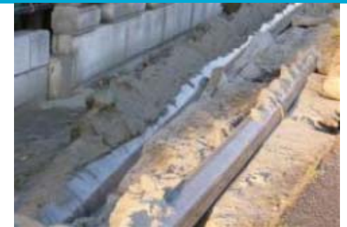
下水管の浮上
