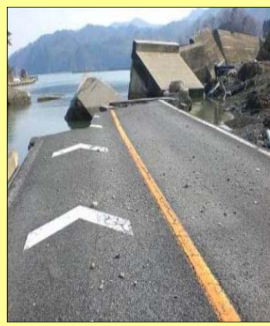
津波で被災した国道45号
