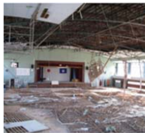
天井材・外装材の脱落
