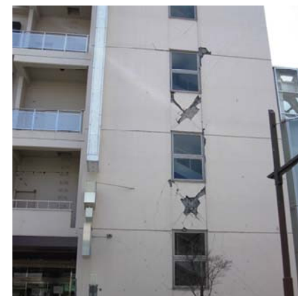
耐力壁開口周辺のせん断破壊
