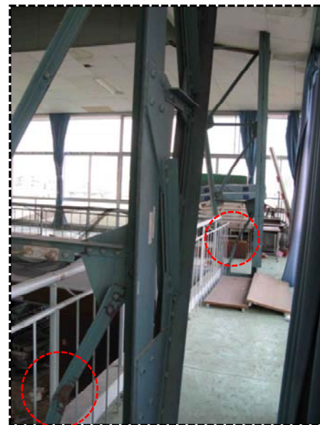
ラチス柱斜材の座屈
