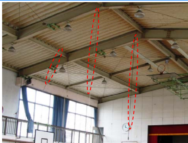
屋根ブレースの破断
