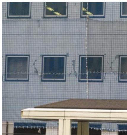
タイルの破損
