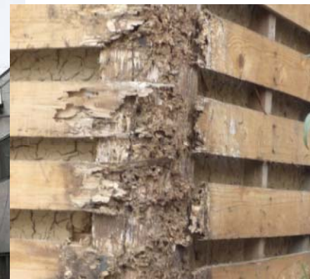
部材の腐朽・劣化を伴う被害
