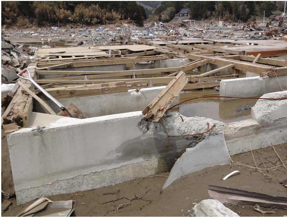
基礎の一部が破壊
