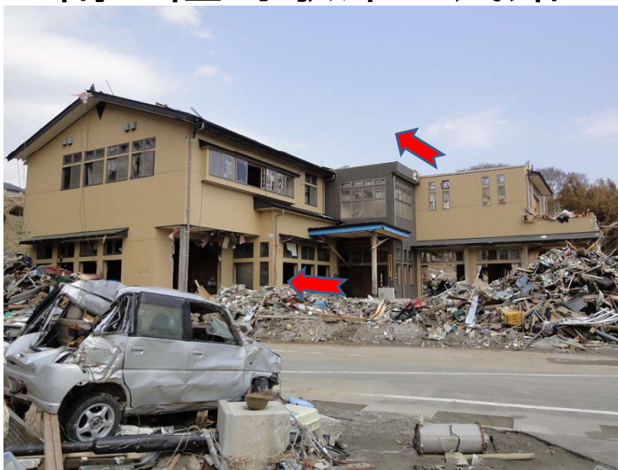
大断面集成材;1階開口、外壁が破られている 1階天井、2階屋根も破られている
