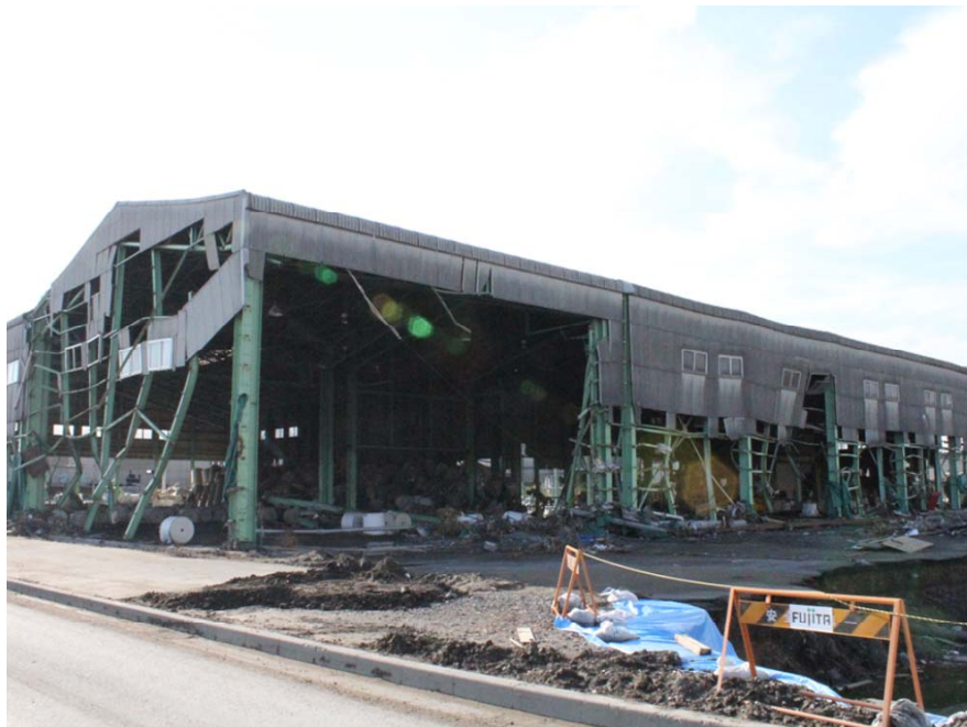
S造：製材工場に隣接する製紙工場、外壁が破られている
