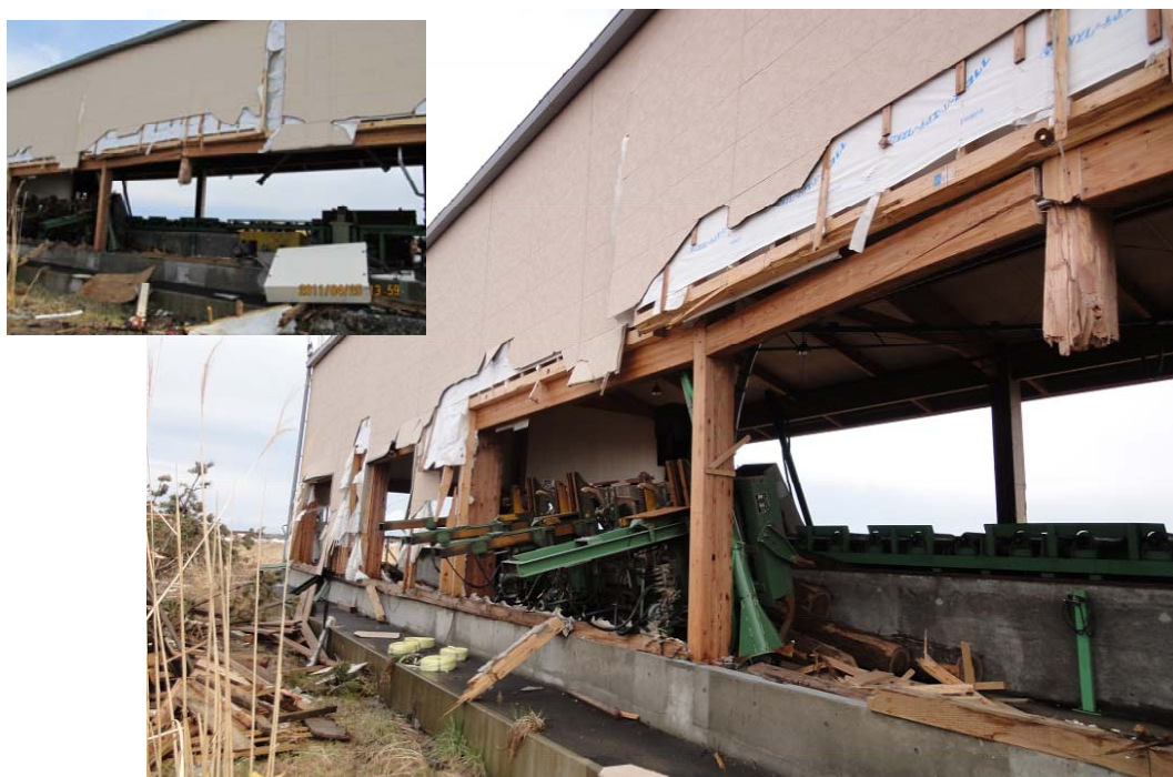
製材工場、製品倉庫; 1階の外壁が破壊されている
