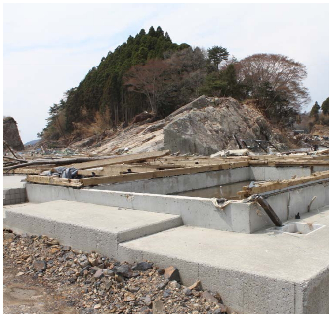
土台、基礎の一部を残すのみ
