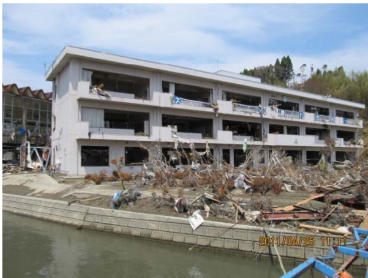
吉浜小学校; 躯体は残っているが、開口部は破られている 1、2階の手すりフェンスは脱落、3階も何か所かを除き、脱落。
