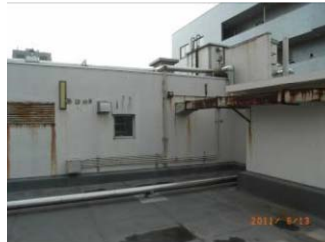
屋上機械室廻り : 配管やガラリ部に錆等の劣化有り
