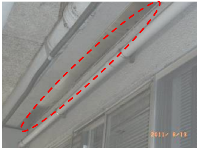
外壁 : エキспанジョイント部に亀裂有り
