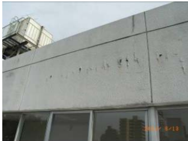
外壁廻り : 爆裂により鉄筋の露出有り
