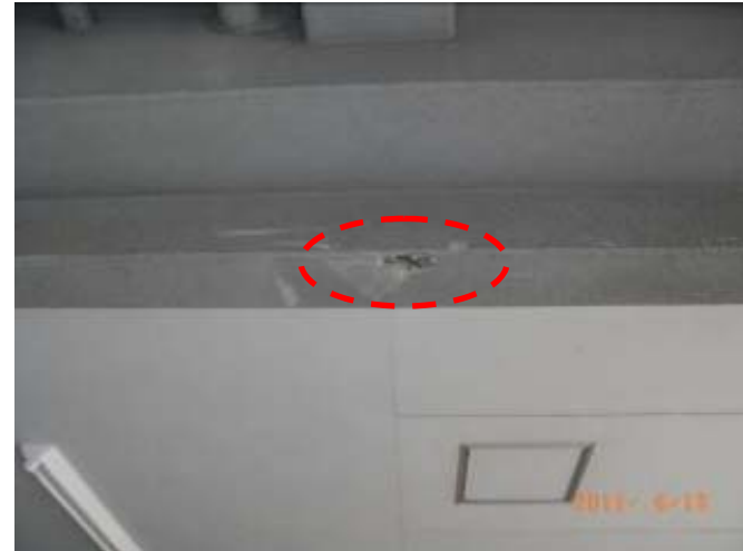
外壁 : ピロティ梁に爆裂、モルタルの落下有り
