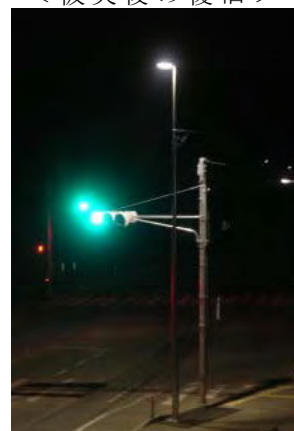
LED 道路照明灯
