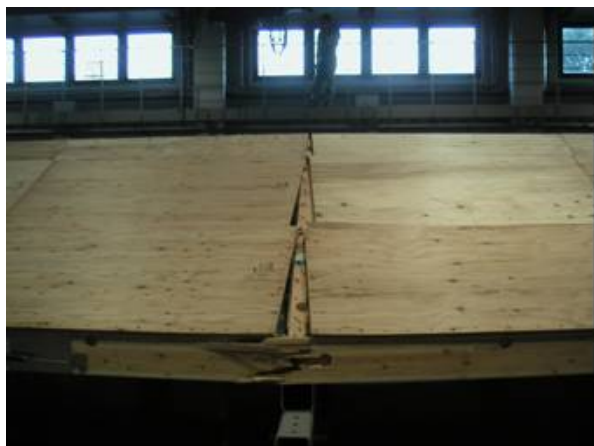
写真 5. 屋根構面の破壊形態
