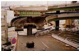
図 地震により崩落した橋梁
