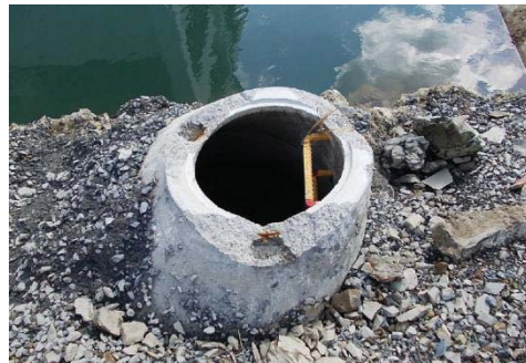
宮城県女川町（蓋の流出）
