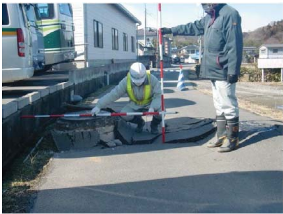
栃木県真岡市人孔突出、路面異常
