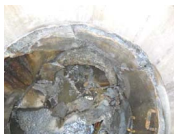
千葉市接合部破損
