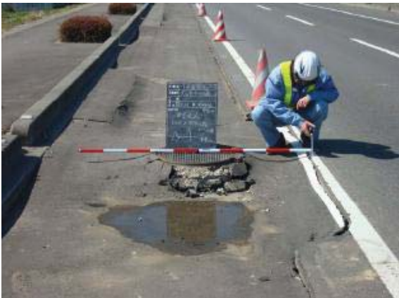
栃木県大田原市人孔突出、路面異常
