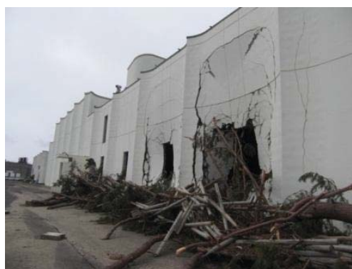
漂流物による建築物への直接被害
