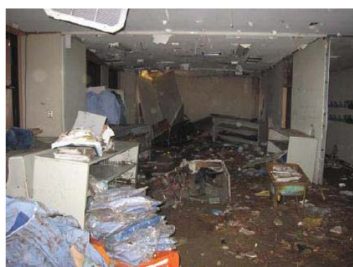
浸水による室内設備の水没被害
