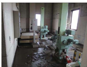
流入ゲート、操作盤浸水
