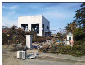
ポンプ場入口フェンス流出
