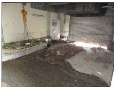
ホッパー室津波により操作盤浸水
