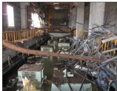
送風機施設への流木等の浸入
