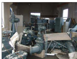
ポンプ場内部
