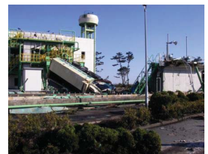
漂流車両による流入ゲート損傷
