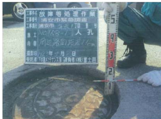
写真 I-1-9 人孔沈下被害例（Bタイプ）浦安市
