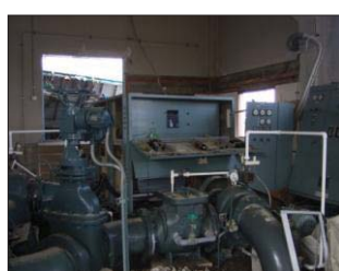
高圧受電盤他転倒
