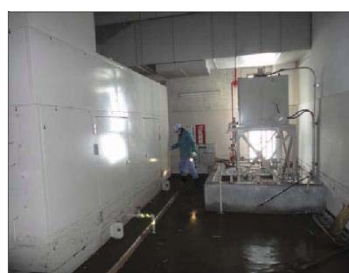
自家発電施設浸水
