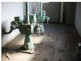
流入ゲート開閉操作器の電気設備 が浸水、全機能停止 (流入渠)
