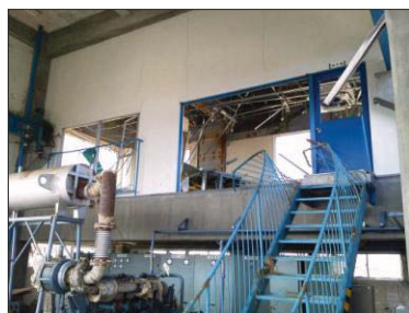
2階操作室 「破損・流出」
