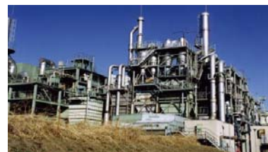
下水汚泥焼却炉
