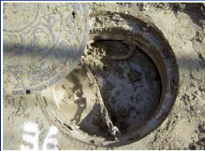
土砂堆積の状況(千葉市)
