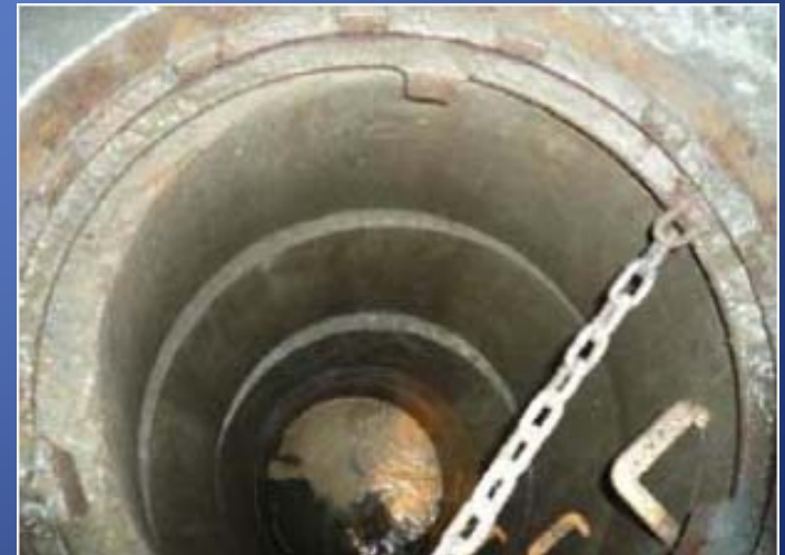
人孔躯体ズレの状況(千葉市)
