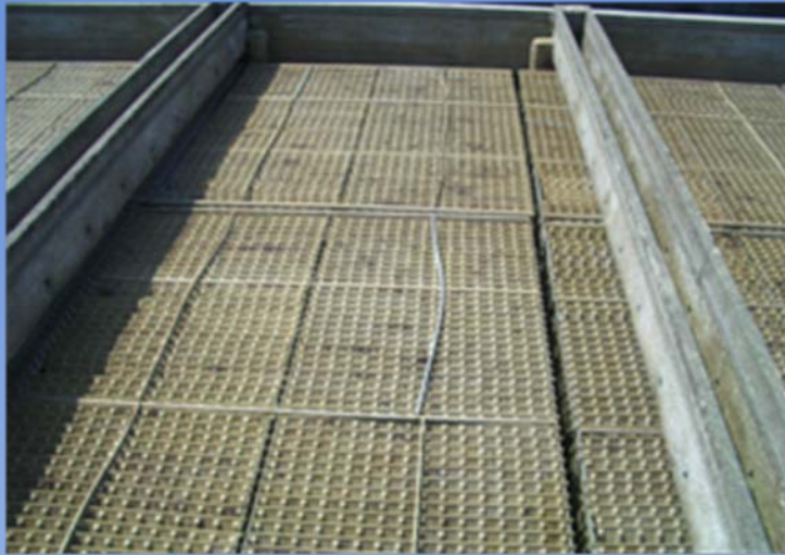
茂庭浄水場沈澱池傾斜版
