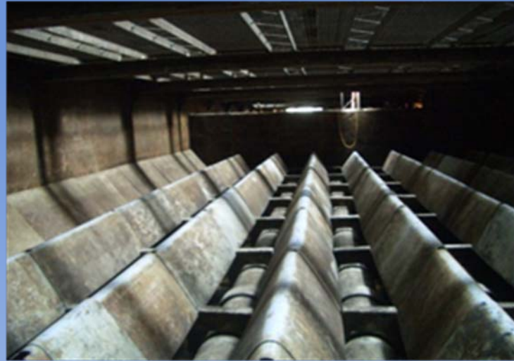
茂庭浄水場沈澱池阻流板
