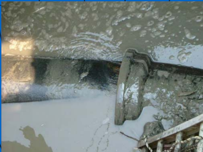
蛇田浄水場新下沼 \phi 500 印籠継手の漏水
