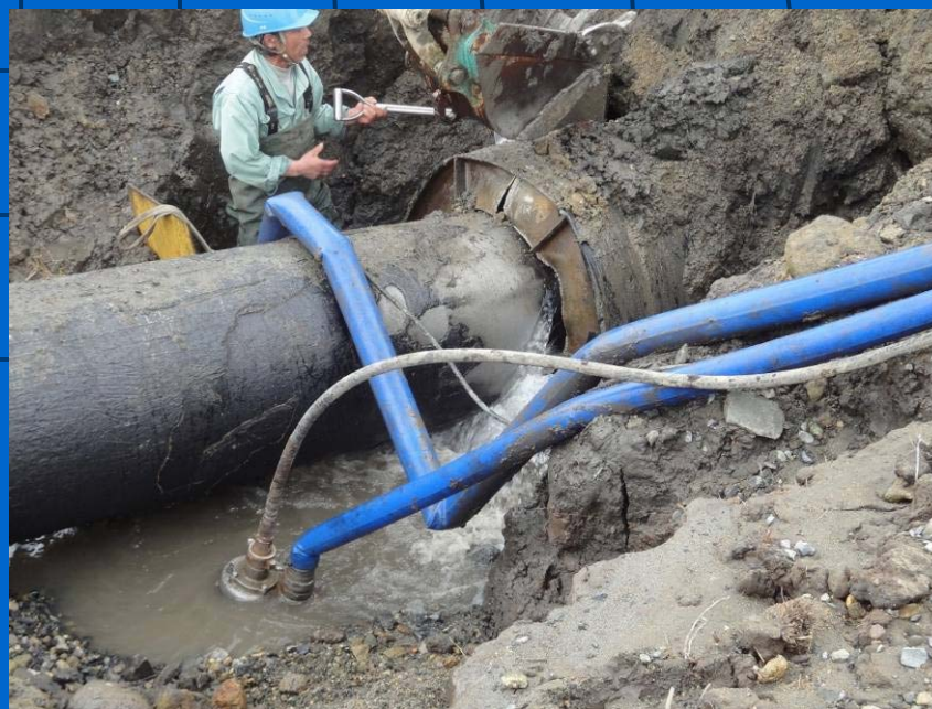
宮城県仙台市内 \phi 700 鋼管 継手部漏水
