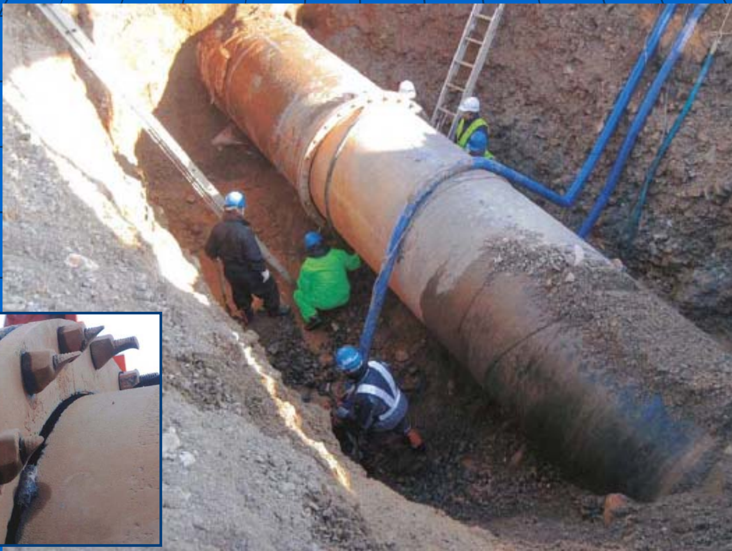
φ1500 ダクタイル鉄管 K形継手の離脱
