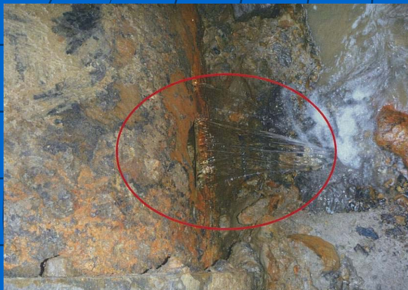
いわき市 \phi 1100 ダクタイル鉄管の腐食
