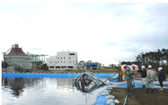
写真Ⅰ-1-30 県南浄化センター簡易処理放流状況の確認
