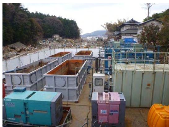
写真 I -1-48 膜分離装置（MBR）の外観
