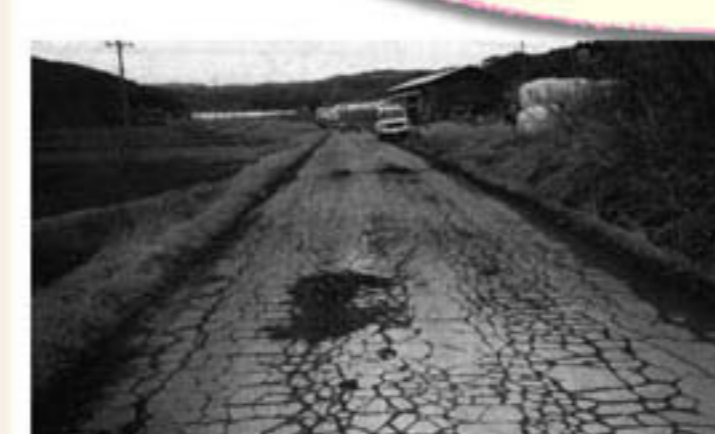
アスファルト舗装面にできた亀甲状のひび割れと、舗装が剥がれてできた穴。
