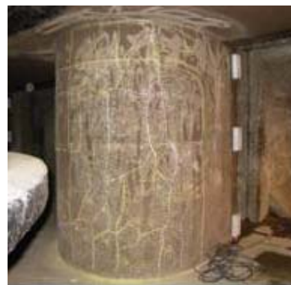
施設内水路に発生したクラック
