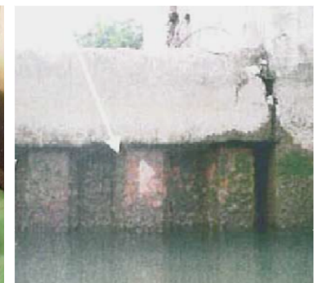
導水路の鋼矢板の腐食
