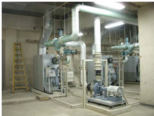
■ ガス温水ボイラー
