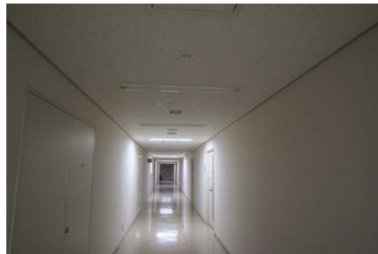
■オフィス廊下照明の節電
