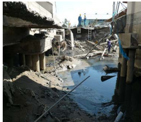
庁舎周囲の地盤流出
