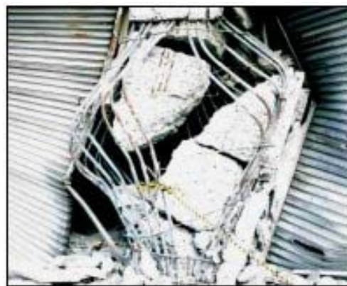
店舗1階柱の圧壊
