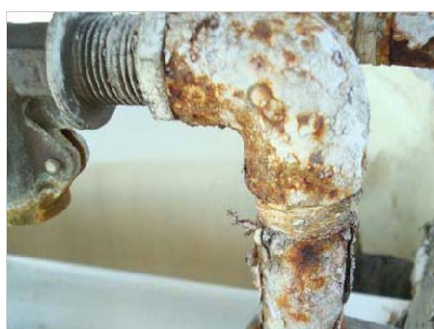
腐食した給水管
