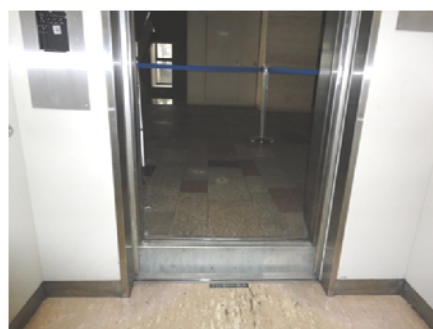
エレベーター着床時の段差
