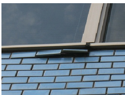
落下のおそれがあるタイル
