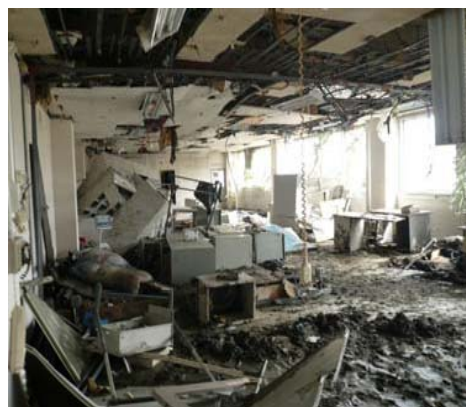
1階事務室浸水
