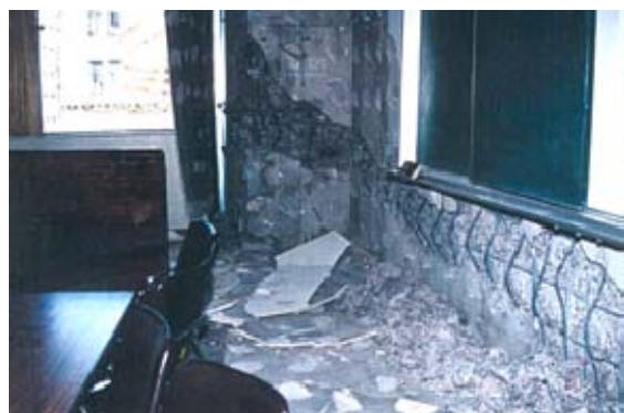
内部の被災状況
