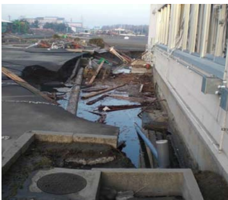
庁舎南側敷地陥没
