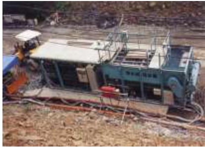
濁水処理装置
