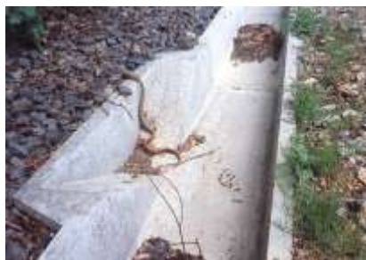
スロープ付側溝
