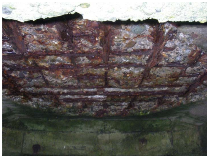
栈橋床版下面鉄筋露出
