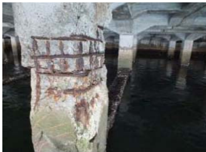
栈橋脚柱部鉄筋露出
