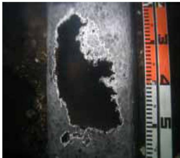
腐食による 鋼矢板開孔
