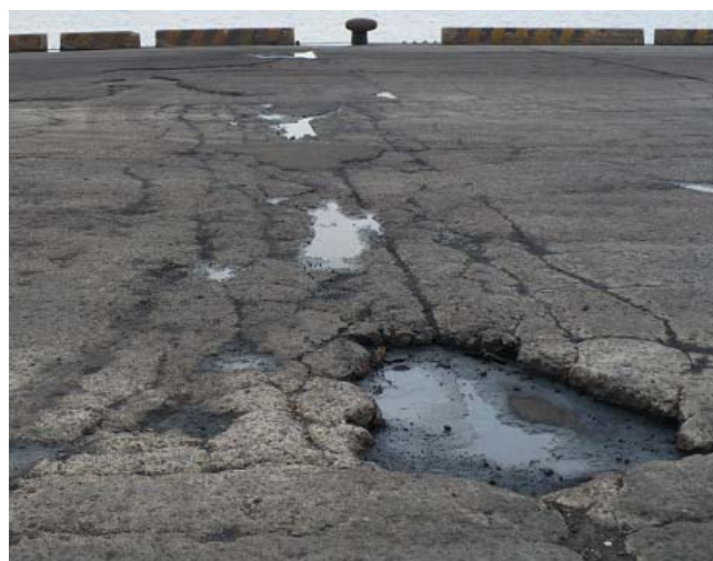
エプロンひび割れ、剥離
