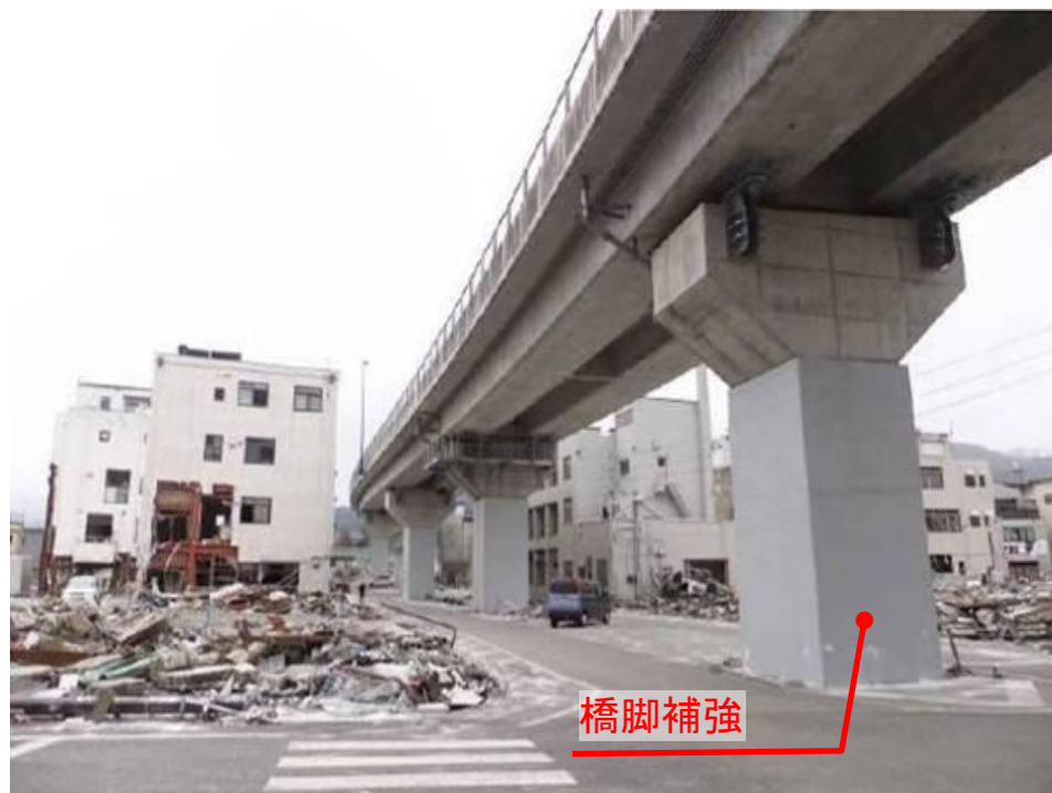
国道45号（観測震度：震度6弱）
