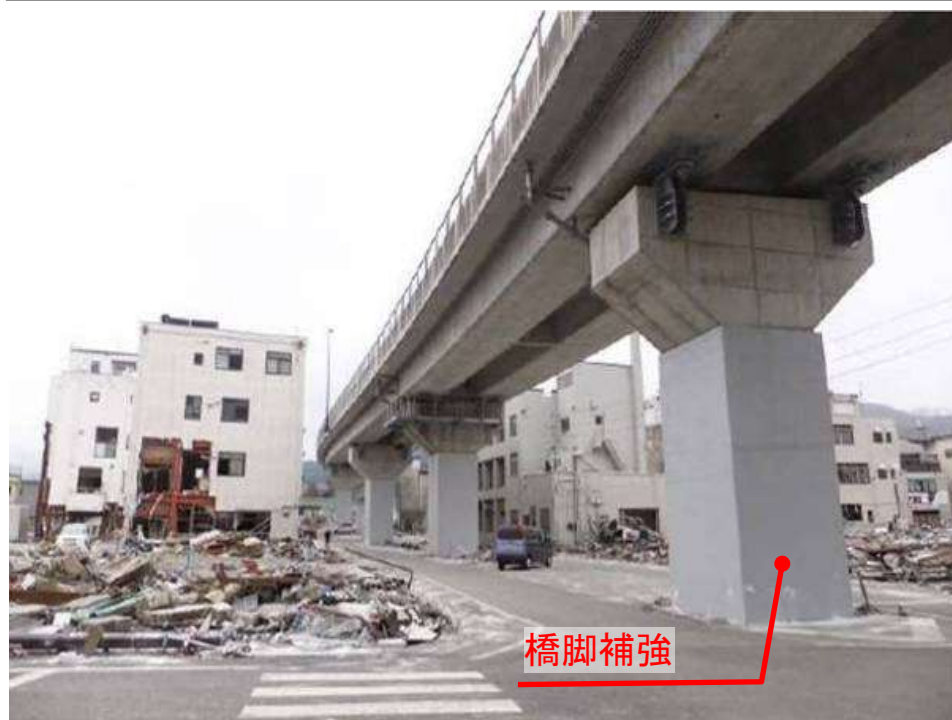
国道45号（観測震度：震度6弱）
