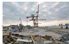
高砂コンテナヤードの被災状況 (H23.3)
