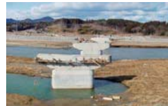
被災状況 (H23.3)
