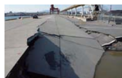
5・6号ふ頭の被災状況 (H23.3)
