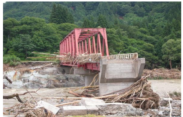
▲福島県只見町矢木沢地区 倒壊した只見線橋梁 【写真提供／東北地方整備局】
