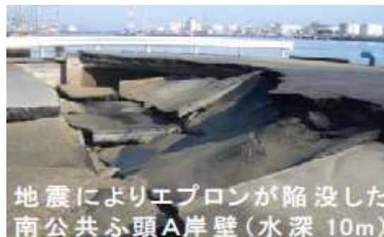
地震や液状化による損壊 (出所) 国土交通省資料
