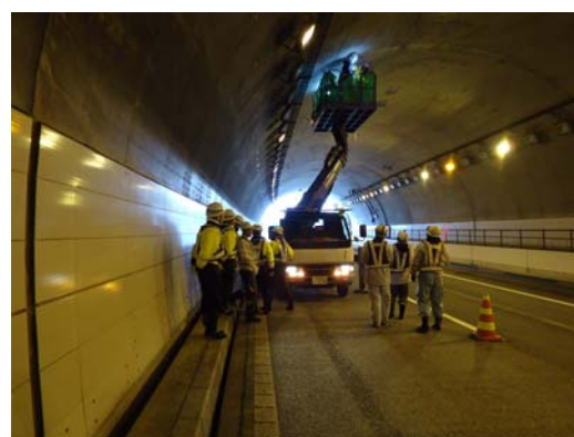
交通規制および点検状況
