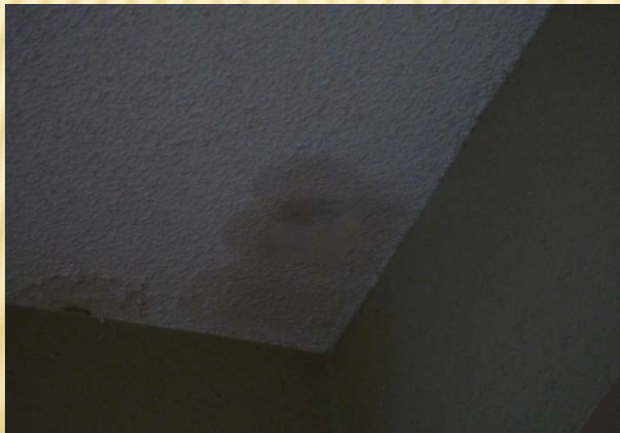
一部劣化(漏水)
