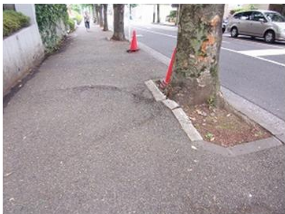
①施工前（根上りした状況）
