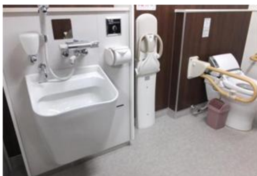
オストメイト用専用流しを設置した多機能トイレ
