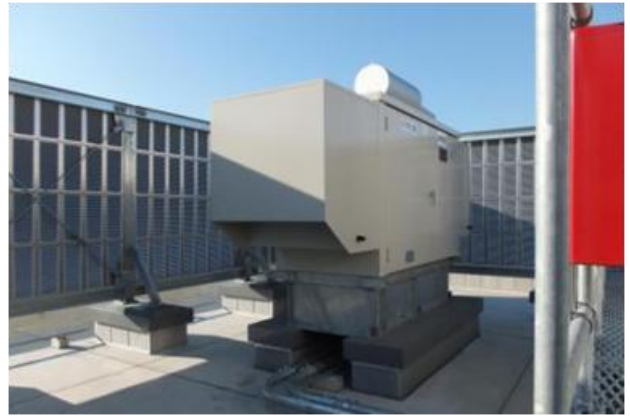
非常時に備える自家発電機
