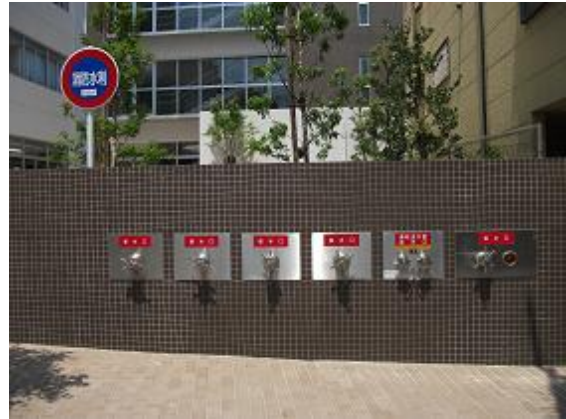
災害時にプールの水を利用できる採水口
