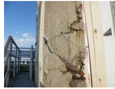
水門の門柱部のコンクリ剥離
