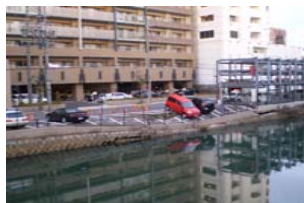
鋼矢板護岸の損壊状況
