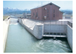
農業用水を活用した小水力発電(従属発電)
