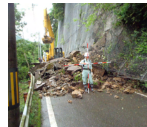
【写真②】 国道168号崩落状況（H24.6）
