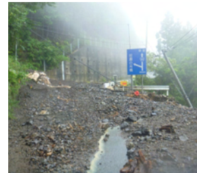
【写真①】 国道168号崩落状況（H23.9）
