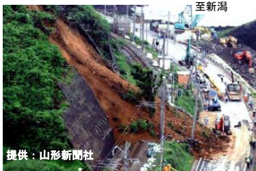
図1 法面崩壊(鶴岡市小岩川地区)
