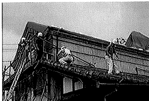
写真-3 調査物件外部屋根被害状況
