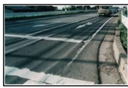
(舗装のわだち掘れ)
