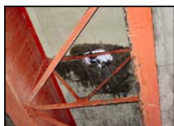
(橋梁の抜け落ち)
