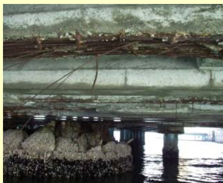
<劣化や変状が顕在化した施設の増加>
