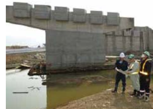
津波により流出した橋の調査
